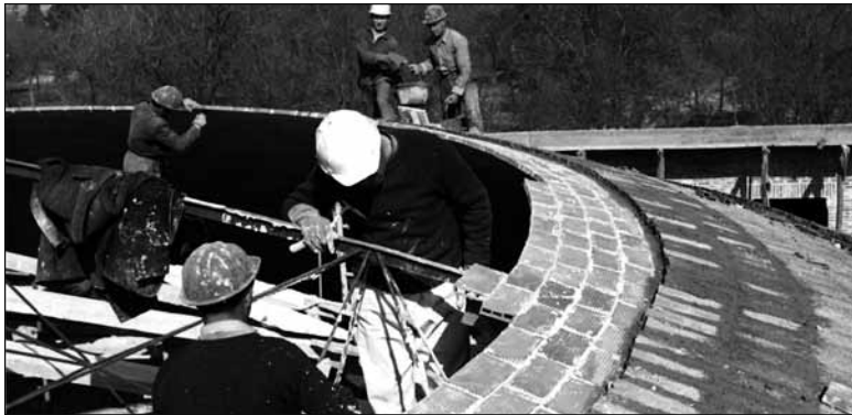
Parroquia de Santa María Madre de la Iglesia en Carabanchel (Madrid) (1966-1969): Moya, con técnicos del Instituto Torroja, supervisando las obras de la cúpula; detalles del proceso constructivo de la misma. [Colección particular]
